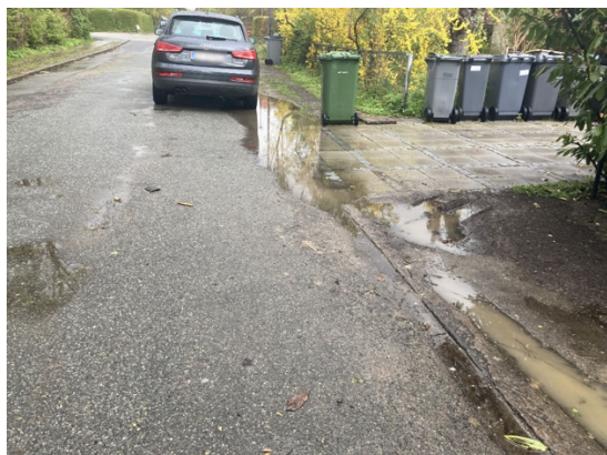
Fortovet ved Engblommevej 29-31
